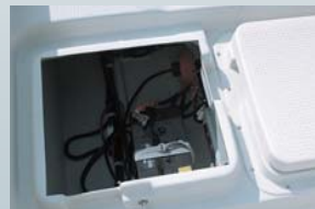
■スターンバッテリースペース
