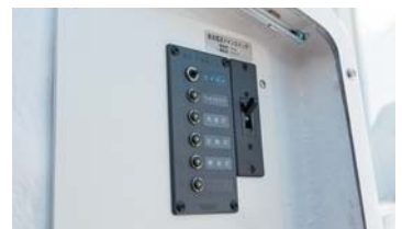
ブレーカーパネル
