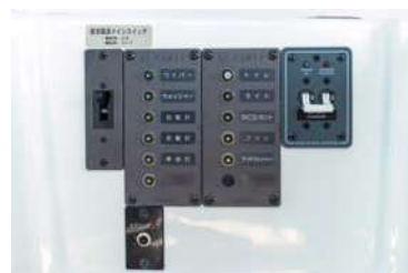
ブレーカーパネル
