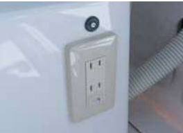
AC100Vコンセント (工場OP)
