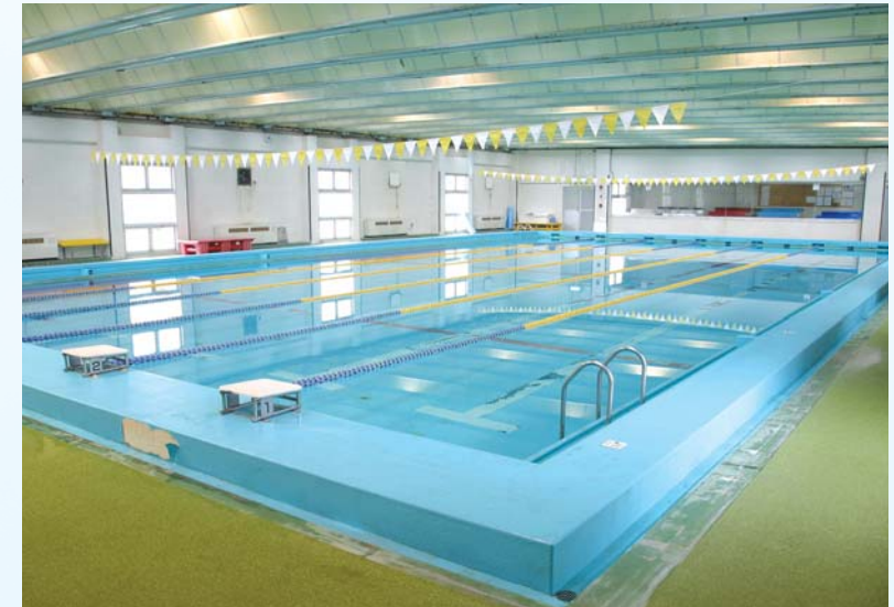
古くなった室内温水プールは年中利用されているため塩素剤などによる劣化がみられる。
