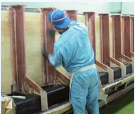
側壁にかかる水圧に耐えられるよう、補強材を一定間隔で配置。
