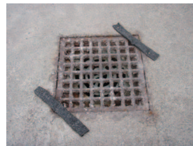
排水舄(2重構造にはなっているが簡易的な固定)
