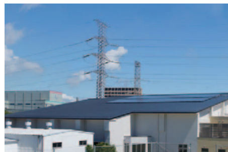
屋根に設置された太陽光発電パネル
