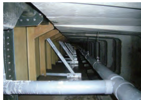
FRPプールのステー
