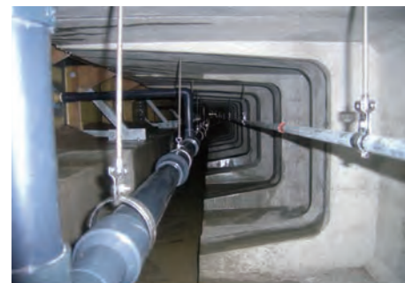
ピット内循環配管
