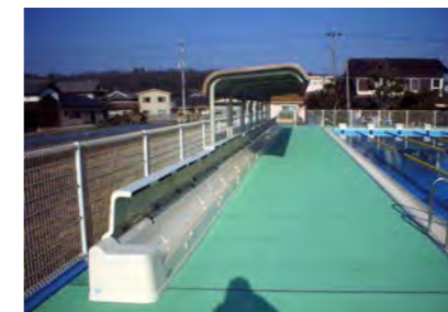
(改修後)プールサイド コースロープ収納ボックスを設置
